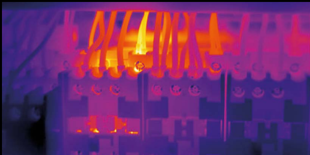
Vorbeugende Instandhaltung von elektrischen Anlagen.
